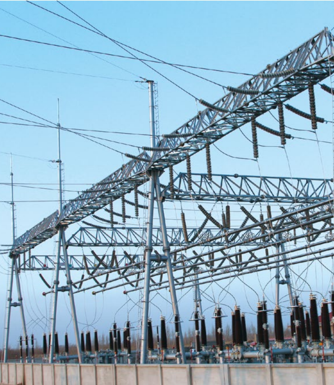
丰金220KV输电线路改造项目 (线路长度16km) مشروع تجديد خطوط نقل الطاقة الكهربائية 220 كف (طول الخط 16 كم) في فنغجين بالصين
