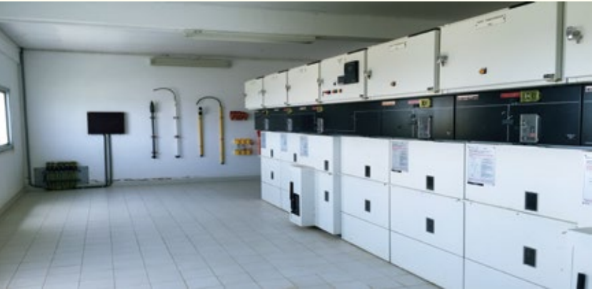
毛里塔尼亚AFTOUT 供水项目中的电控系统 نظام التحكم الكهربائي لمشروع امدادات المياه أفتوط في موريتانيا
