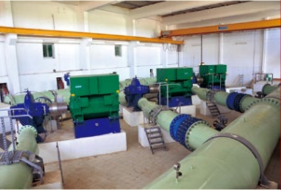
Beni Nadiji 泵站设备（日输水量150000立方米） محطة ضخ بني نادجي (حجم توصيل المياه 150,000 متر مكعب يوميا)
