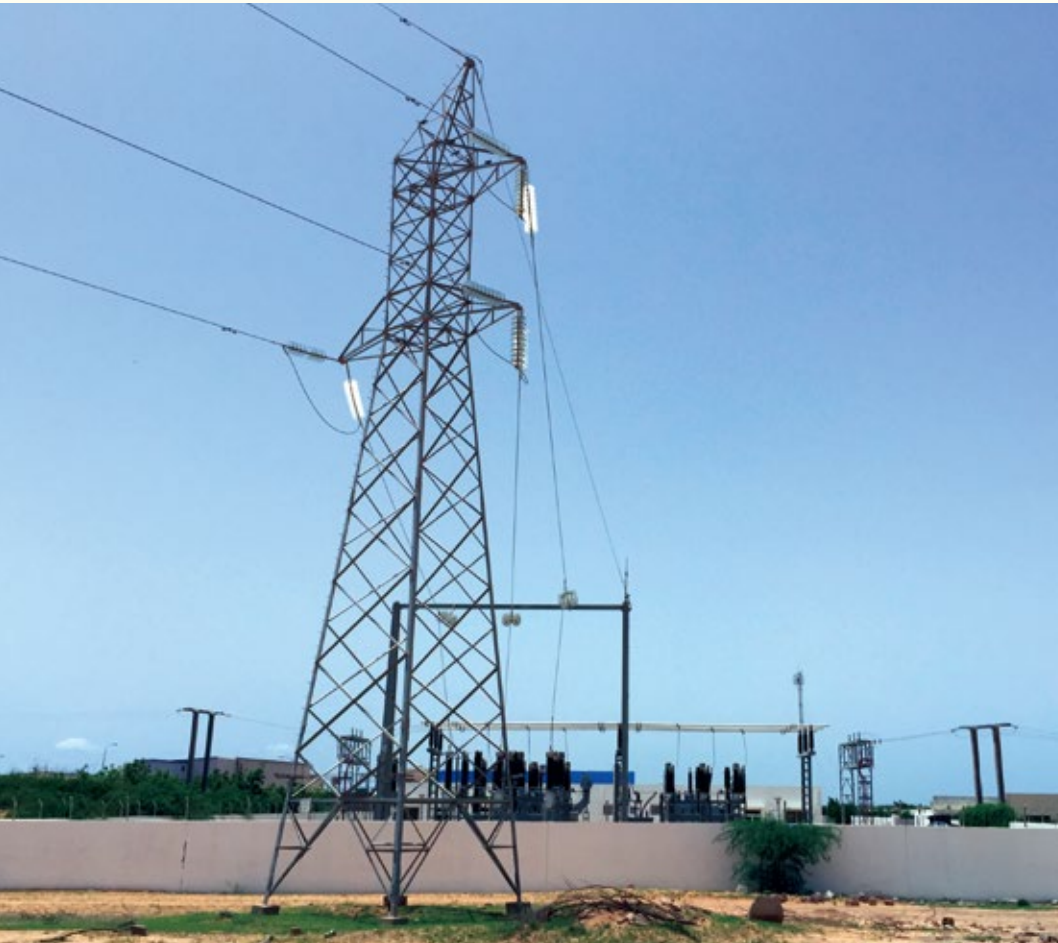
毛里塔尼亚AFTOUT 供水项目中的变电站 محطة كهرباء فرعية لمشروع المياه أفتوط في موريتانيا
