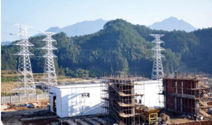
亚东水泥厂220KV变电站工程 (电站规模: 2x75MVA ) 220KV مشروع محطة كهرباء فرعية بجهد 220 كف بسعتها 75*2 ميجا فولت أمبير في معمل أسمنت يادونغ بالصين
